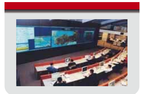
Sala de control
